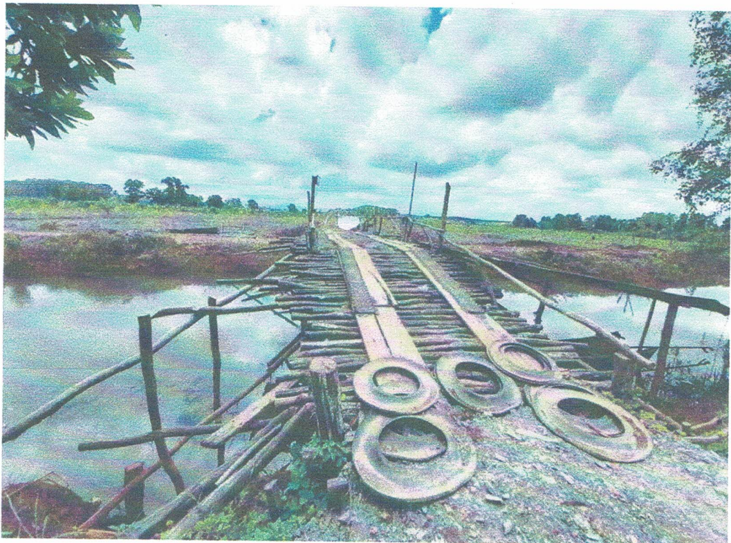
สภาพทั่วไปบริเวณที่ก่อสร้างสะพานชั่วคราวข้ามคลองกระแจะ
